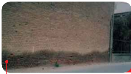
Umidità di risalita su muro di mattoni pieni. Intervento: una fila di cartucce Speedy.
